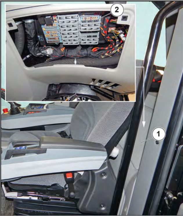
Afbeelding 299: Zekeringen en relais in cabine
